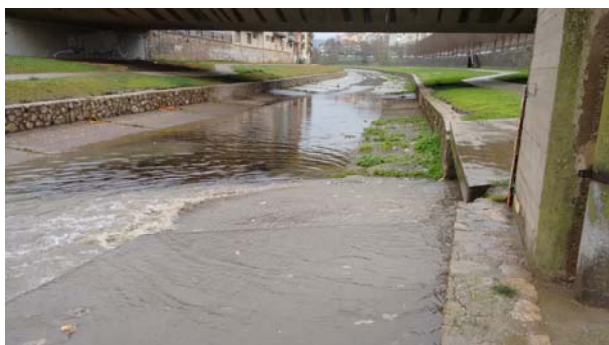
Slika 1: Preplavanje mešane kanalizacije prek razbremenilnika – 7. 2. 2016.
